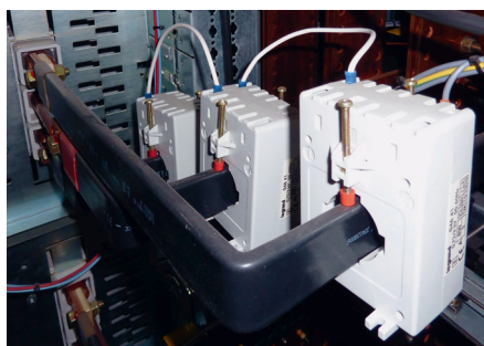
Transformateurs d'intensité montés directement sur les barres souples
