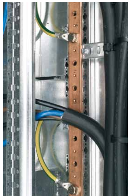
Borne principale en gaine à câbles constituée d'une barre cuivre 32 x 5 mm
