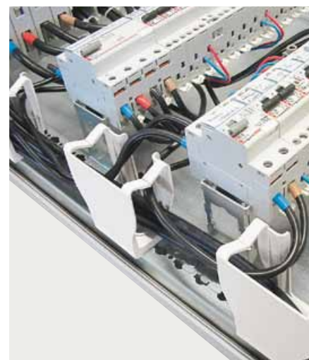
Exemple de circulation de filerie réalisée par bracelets
